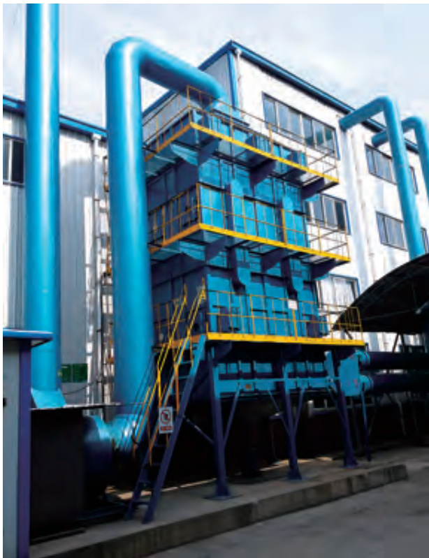
唐村公司 VOCs 治理设备
