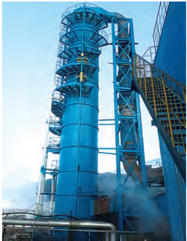
锅炉烟气治理改造工程脱硫塔
