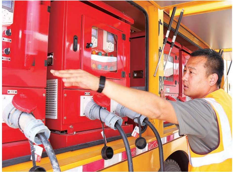
救援現場發電照明車
