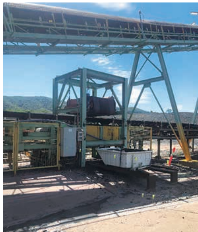
兖煤澳洲洗煤厂原煤入洗系统
