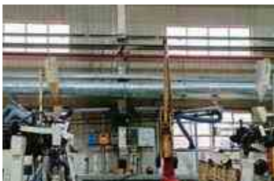
东华重工烟尘收集设施
