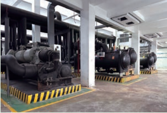
李樓煤業礦井餘熱綜合利用項目設施
