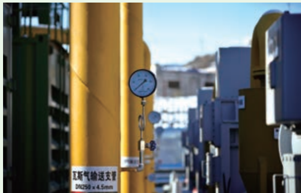
硫磺溝煤礦瓦斯發電項目設施
